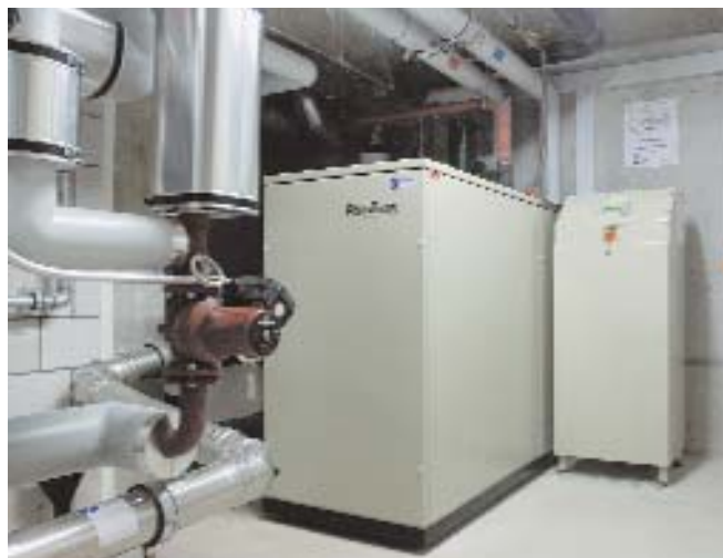
Gasmotor-BHKW, modulierend von 7-20 kWe und 12-38 kWth ermöglichte Minergie-Standard in einer Überbauung in Langenthal. Le couplage chaleur-force à moteur à gaz modulant de 7-20 kWe et 12-38 kWth, a permis d'atteindre le standard Minergie dans le lotissement à Langenthal.
