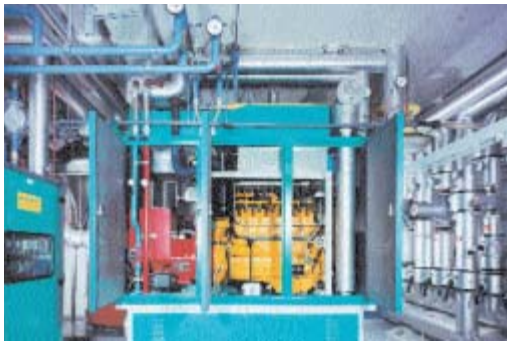
Gasmotor-Blockheizkraftwerk im Hallenbad Männedorf; rechts der Gasmotor, links der Generator Couplage chaleur-force à moteur à gaz de la piscine couverte de Männedorf; moteur à gaz à droite, générateur à gauche
